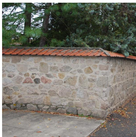
exemple de mur en pierres grossièrement équarries sur un face et rejointoyé pouvant être laissé apparent...
